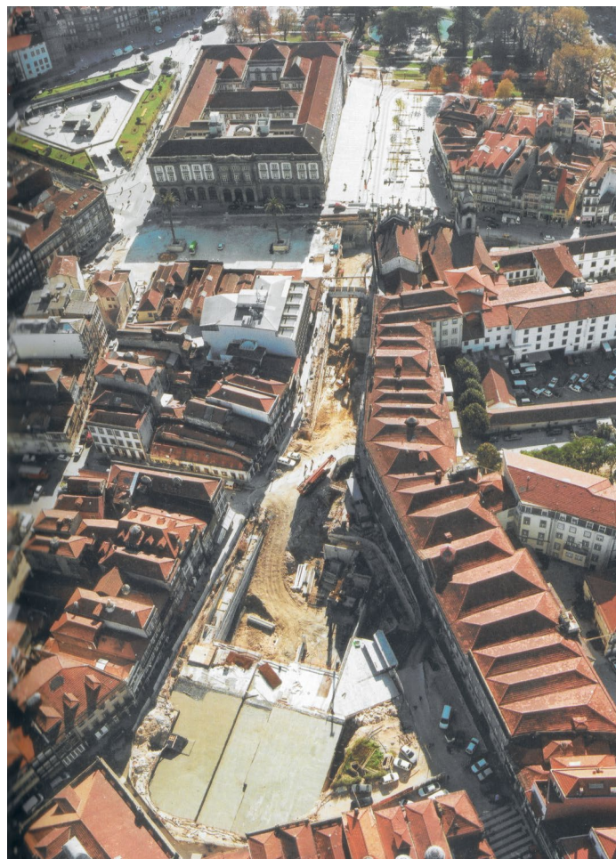
Vista aérea das obras na Praça de Carlos Alberto, no âmbito da Porto 2001 © Francisco Piqueiro
